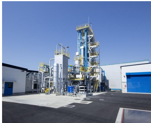
吉川再生可能エネルギーセンター
